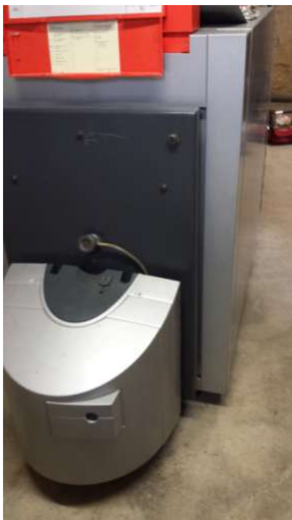
(Chaudière Viessmann avec bruleur Weishaupt de 170 KW)
