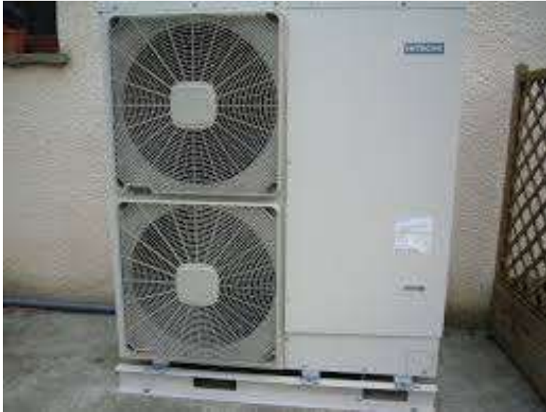
Pompes à chaleur Hitachi S80 air/eau)
