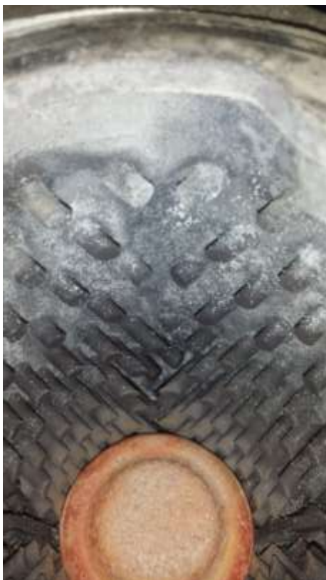
(Photo du corps de chauffe avant le nettoyage)
